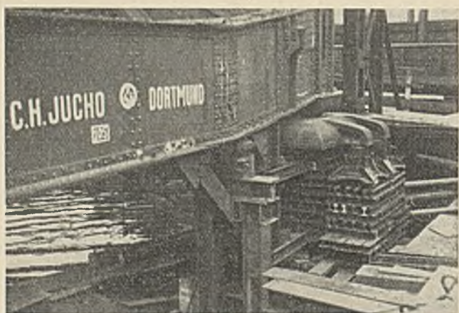
Abb. 30. Absenkung mit Schienenstapeln auf der Südseite (Brücke teilweise gesenkt).
