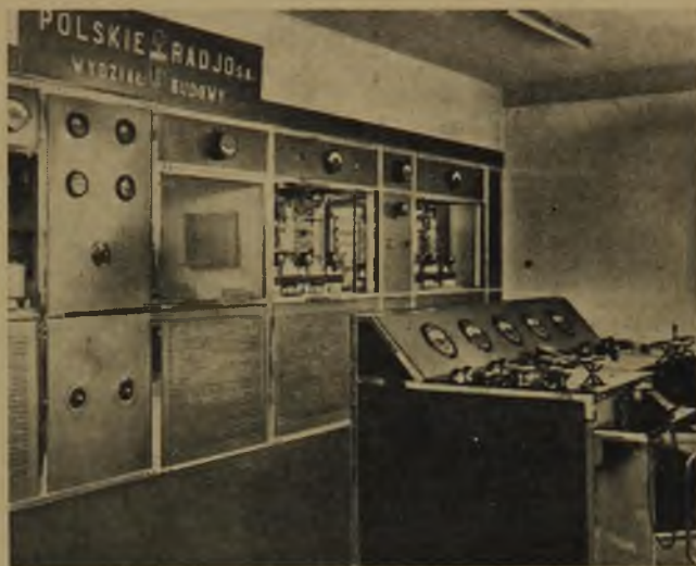
Rys. 14. Sala aparatury nadawczej 20 kW rozgłośni Toruńskiej wykonanej przez Wydział Budowy Polskiego Radia.
