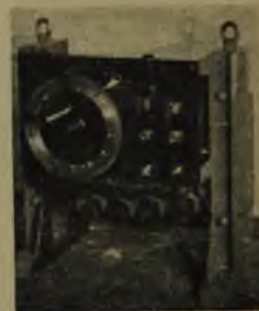
Transformator mały nastawni- czy o mocy 10 kVA.
