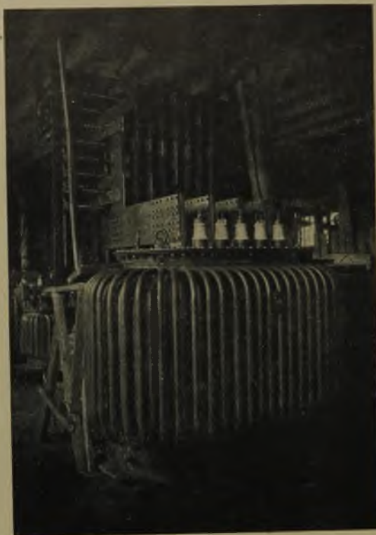
Transformator 1-fazowy, 700 kVA wraz z przełącznikiem 5000 — 10000 — 20000 A, mogący dostarczać do 24000 A, dla pieca elektrycznego.
