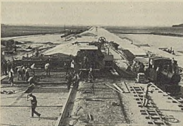
Abb. 1. Überblick über die Baustelle bei Unterhaching. In der Mitte Betonmischmaschine, die eigens für den Bau der Reichsautobahn entworfen wurde.
