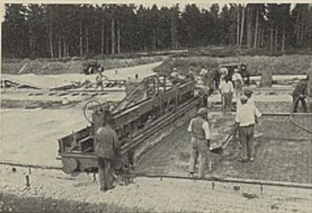
Abb. 3. Der auf zwei Schienen laufende Straßenfertiger mit der Stampfbohle bei der Arbeit.
