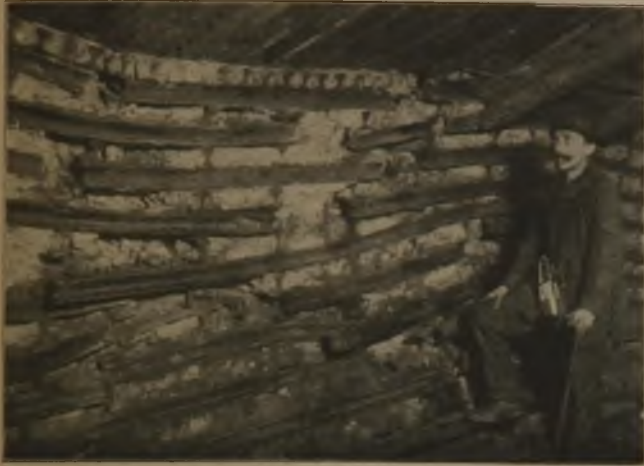
Fig. 8. Durch Gebirgsdruck zerstörter Eisenfeilerbeton
