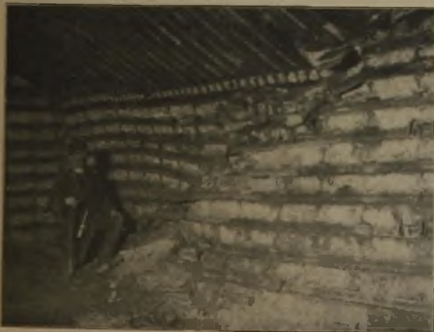
Fig. 9. Durch Gebirgsdruck zerstörter Eisenfeilerbeton.
