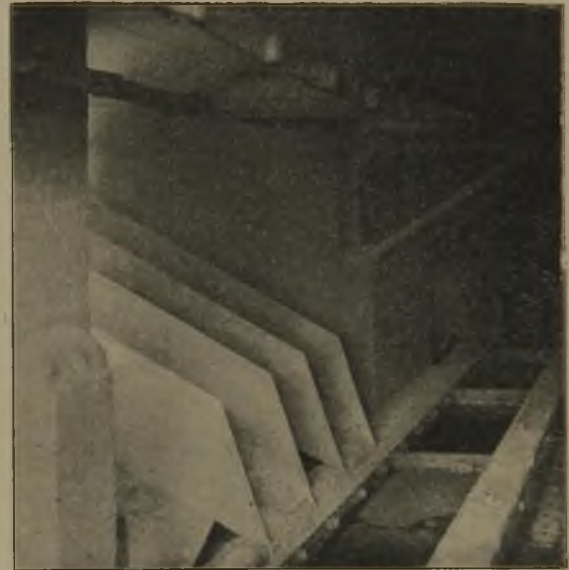
Fig. 3. Ansicht des Aschenkanals mit Förderer.
