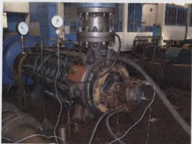
Rys. 9.8a. Stacja prób Fabryki Pomp. Widok pompy OW-250M/8 na stanowisku pomiarowym Fig. 9.8a. Test station of the pump factory. View of an Ow-250M/8 pump on the test stand
