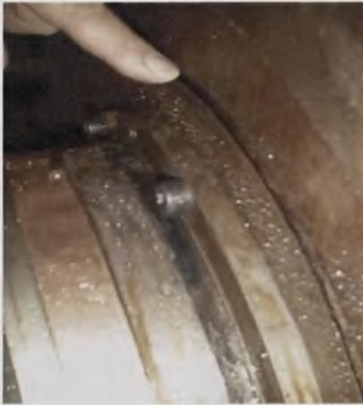
Rys. 9.12. Rozwarstwienie kadłuba tłoczno-pompy pod tarczą odciążającą, pod wpływem sił od ciśnienia przed tarczą Fig. 9.12. Stratification of the outlet body of the pump under the balance disk affected by forces of the pressure under the disk
