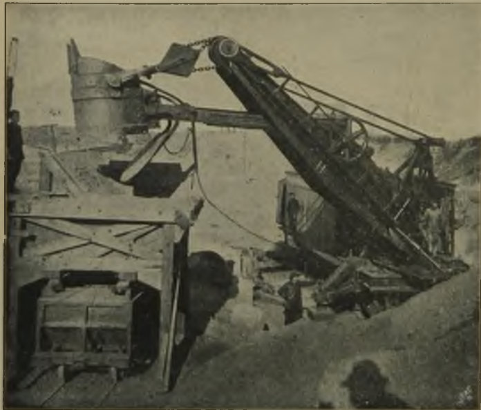
Fig. 45. Dampfschaufel bei der Entleerung des Löffels. Marion Steam Shovel Co., Marion, Ohio.
