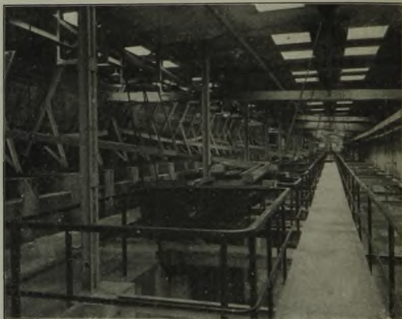
Abb. 12. Schliech-Verdichtungsspitzkasten und Entwässerungskasten.
