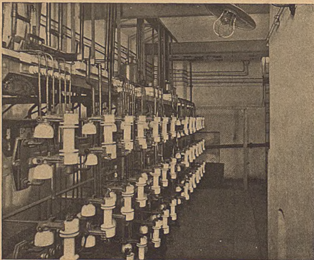
Fig. 8. Rückseite der Zentral-Schalttafel des Zwickauer Steinkohlenbauvereins. Ausgeführt von der Firma Schuckert & Co.
