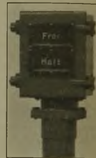
Abb. 2. Anzeigevorrichtung im Maschinenraum.
