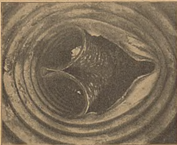
Abb. 2. Blick in das aufgerissene und eingebeulte Flammrohr.
