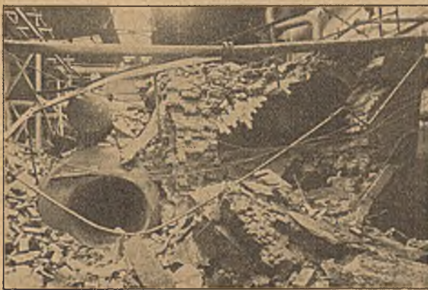
Abb. 1. Zerstörungen am hintern Mauerwerk des explodierten Kessels und seines Nachbarkessels.
