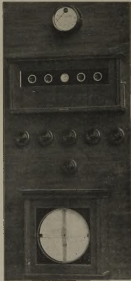
Abb. 1. Wand-Schalttafel in der Feuerwache.
