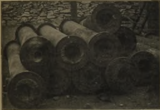
Abb. 1. Steigerohre, teilweise mit Graphit verstopft.
