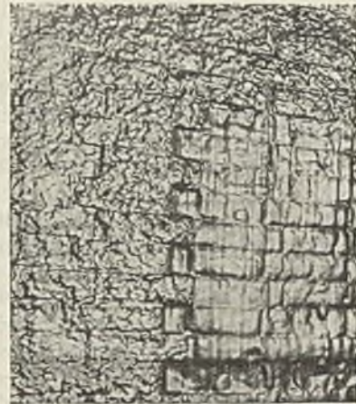
Abb. 5. Verschiedener Erhaltungszustand von tongebundenen Silikasteinen und Schamottesteinen in einer Kohlenstaubfeuerung nach 2500 Betriebsstunden.
