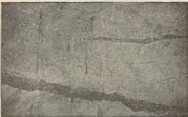
Abb. 6. Nach Einbringung von Zement ausgefrorene Kluft in einem Tiefkälteschacht.
