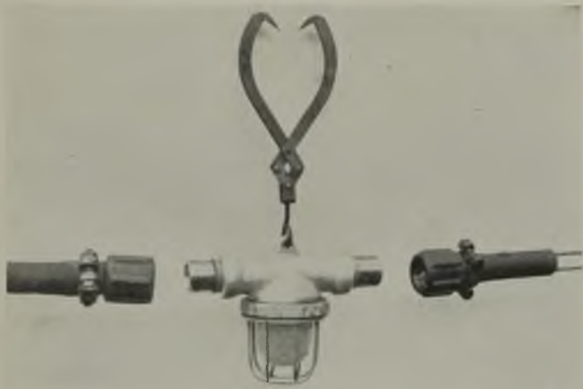
Abb. 1. Anordnung der Beleuchtungskörper in der Kabelleitung.
