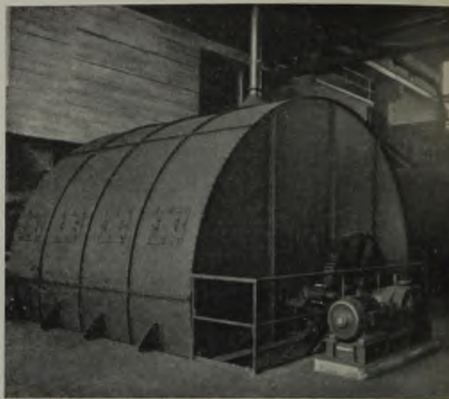
Abb. 3. Einzelantrieb einer Siebtrommel mit Wirbelstromläufer.
