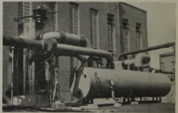
Abb. 1. Ansicht der Abdampfentölungs- und -speicheranlage.
