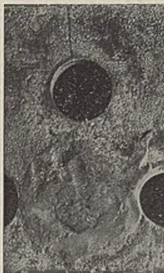
Abb. 3. Rundliche Erhöhung zwischen den Niete; Nietlochriß.
