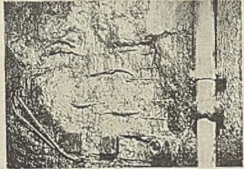
Abb. 9. Abplatzen des Betons von der Schachtwandung.
