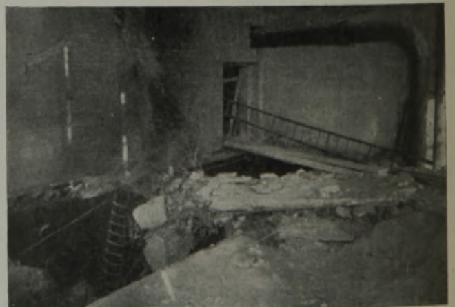
Abb. 2. Wirkung der Explosion.
