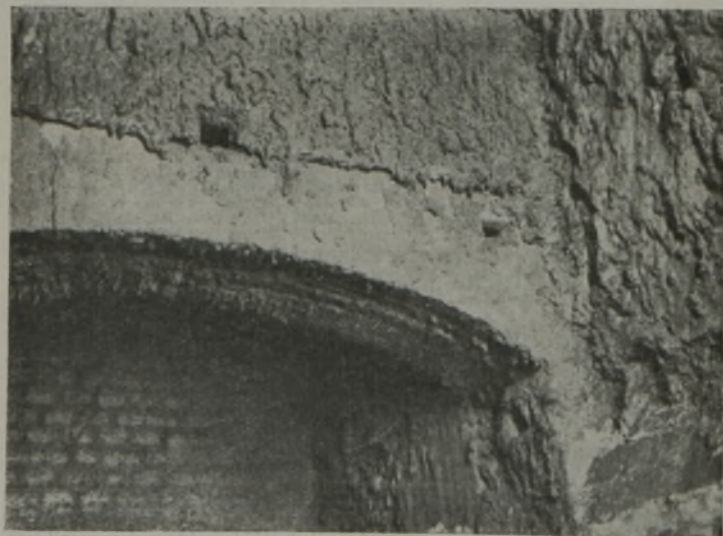
Abb. 2. Gewölbebogen aus Vinconit-Stampfmasse in einer Kohlenstaubzusatzfeuerung nach 4000 Brennstunden.
