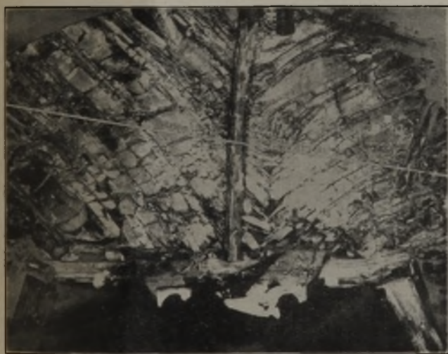
Abb. 3. Schieferung und Verformung des Hangenden beim Nachreißen eines Querschlagcs auf der Zeche Sachsen bei Hamm. Die weiße Linie bezeichnet die ursprüngliche Lage der Schichten.
