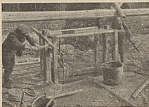
Abb. 4. Duckelschachtbetrieb. Grube Helena bei Chlewiska.
