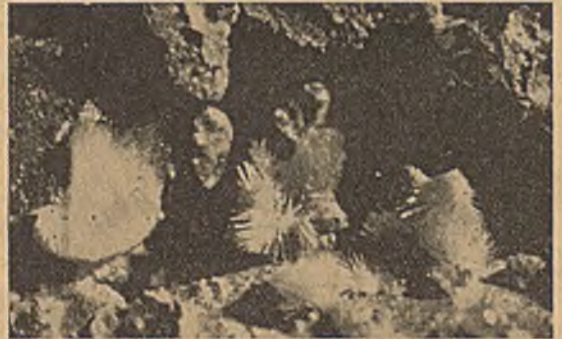
Abb. 9. Betonzerstörung durch Sulfatbildung.
