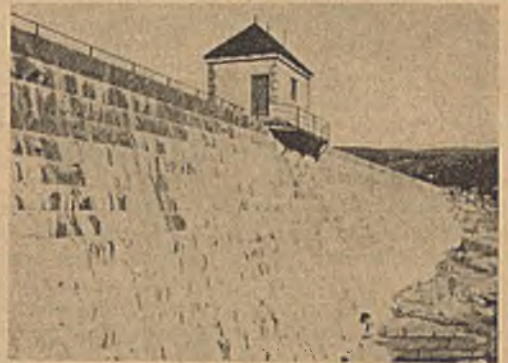
Abb. 12. Abscheidung von kohlensaurem Kalk an einer Talsperre.
