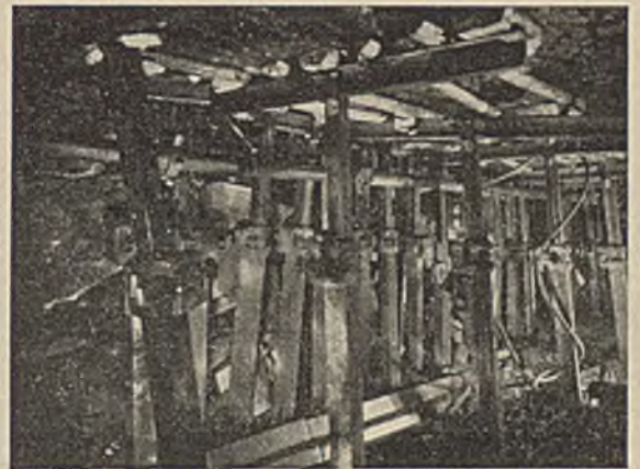
Abb. 22. Durch enggesetzte Doppelreihe und einfallenden Hilfsbau gesicherte Bruchkante bei 1,10 m breitem Förderfeld und 2,50 m Flözmächtigkeit, Bettina-Schacht, Olsagebiet.
