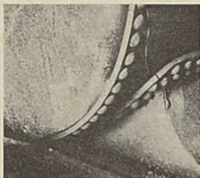
Abb. 2. Bruch einer Stumpffeuerschweißung in der Ecke der Wasserkammer eines Mac-Nicol-Kessels.
