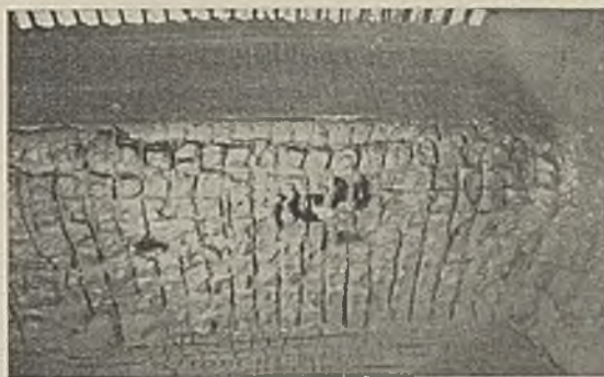
Abb. 9. Hängendecke aus einer Wanderrostfeuerung nach 5000 Brennstunden.
