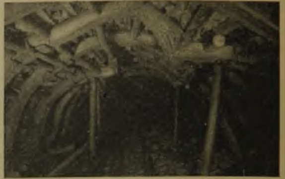
Abb. 10. Der Zustand der Holzgestelle der 3. Sohle 4-5 Monate nach dem Einbringen.
