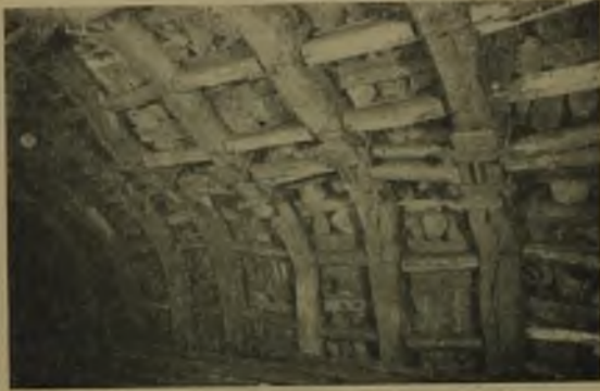
Abb. 8. Das Aufplatzen der Stempel und Kappen bei den Holzgestellen der 3. Sohle.
