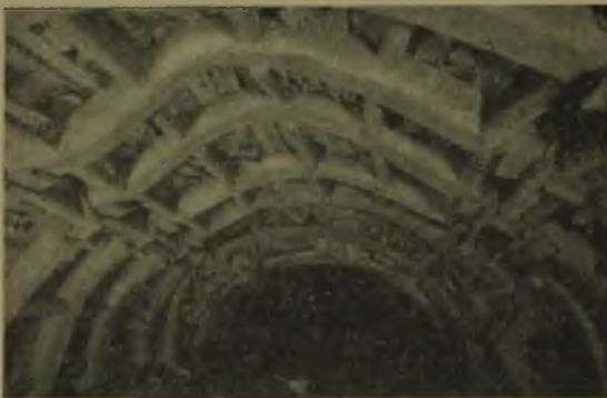
Abb. 9. Die Verformung der Kappen auf der 3. Sohle.
