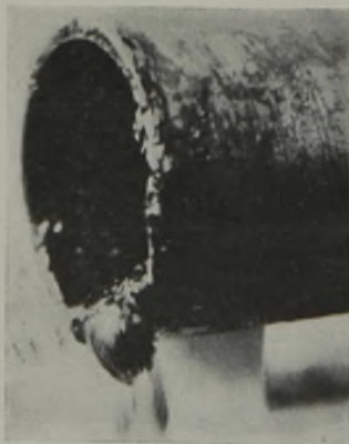
Abb. 2. Ablaufstutzen des Tauchverschlusses an der Niederschlagsvorrichtung.
