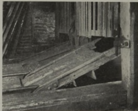
Abb. 11. Anschlußbühne an einem Blindschacht.
