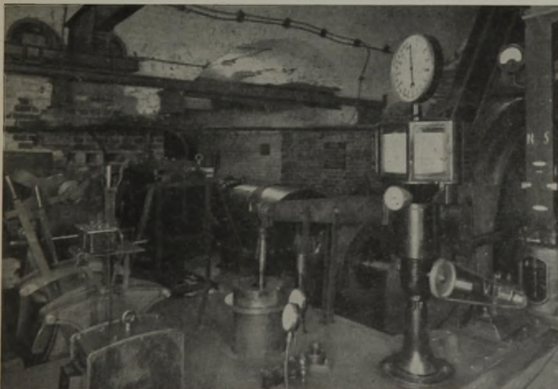
Abb. 12. Blick in den Maschinenraum.
