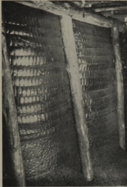
Abb. 3. Padragewebe nach der vor 3 Tagen erfolgten Einbringung von nassen Waschbergen (Flöz Anna mit 2,30 m Mächtigkeit und brüchigem, druckhaftem Hangenden).
