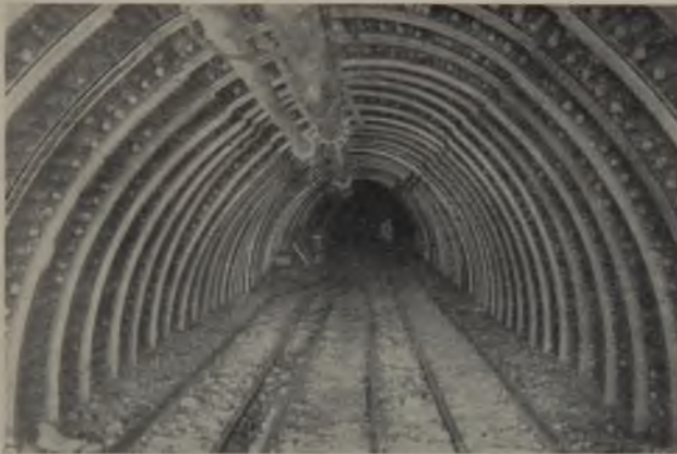
Abb. 8. Offener Bogenausbau in Portalprofil mit starrer Verschraubung.
