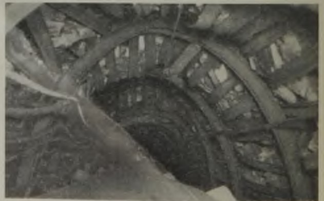
Abb. 13. Beanspruchung des Verzuges in einer Bandstrecke.
