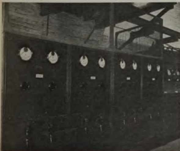
Abb. 2. Gleichrichteranlage von vorn.
