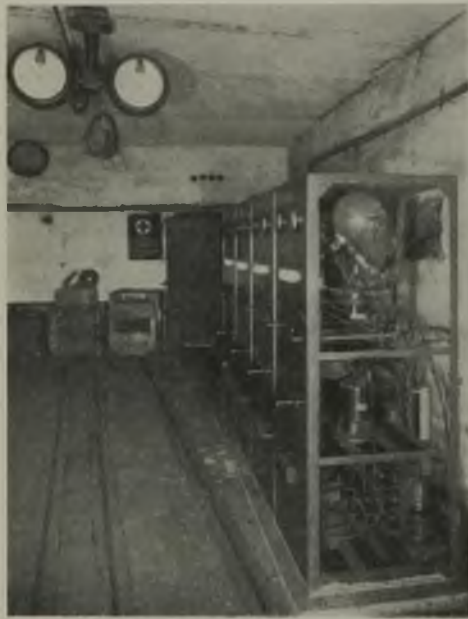
Abb. 6. Aus 4 Gleichrichtern bestehende Anlage auf der Zeche Shamrock.
