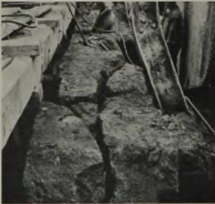
Abb. 4. Bergschäden an der Mauer des Hafens Bottrop.
