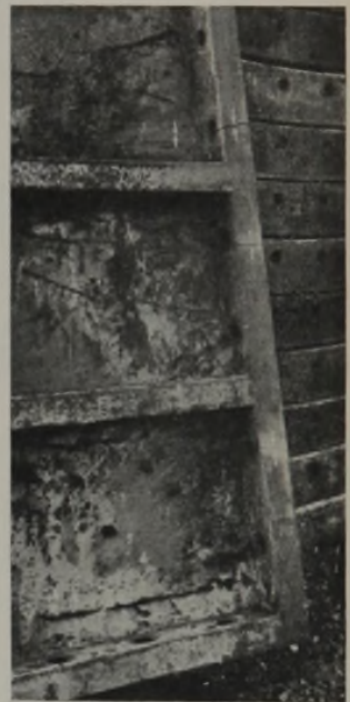
Abb. 6. Risse in den Tübbingplatten.
