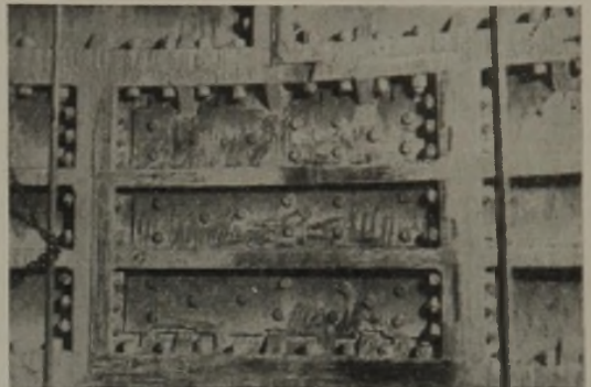
Abb. 14. Ausbesserung eines Tüblings mit Blech und Stiftschrauben.
