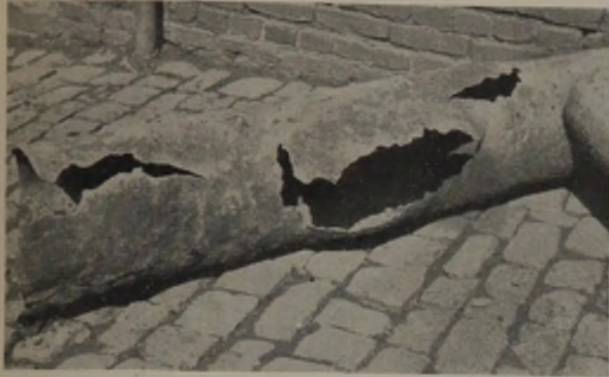
Teilstück der zerstörten Rohrleitung.
