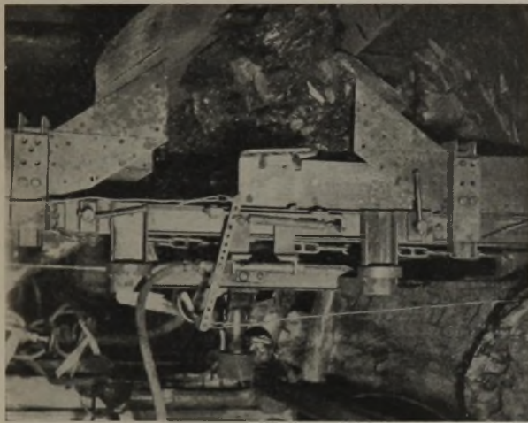
Abb. 3. Antriebstelle in der Mittelstrecke.
