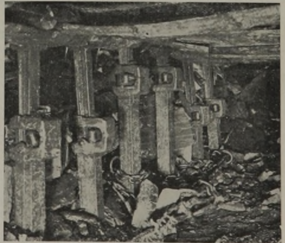
Abb. 1. Reihenstempel bei einfallend angeordnetem Strebausbau.
