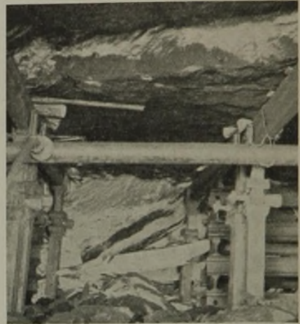
Abb. 5. Abriß von Sandsteinhangendem infolge Aufrechterhaltung des Pfeilerfeldes.
