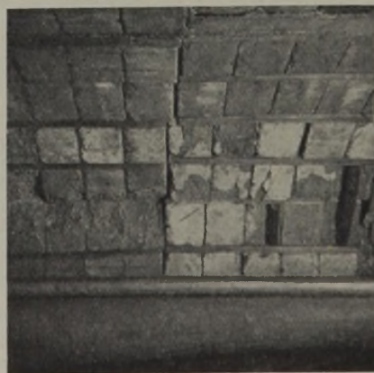
Abb. 7. Betonsteinzerstörung durch Kantenpressung, Schub und Druck.
