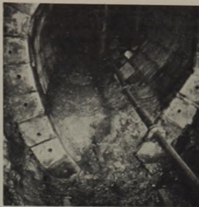
Abb. 2. Deformierung eines Einsteinform-Betonausbau infolge Stoßdruckes.
