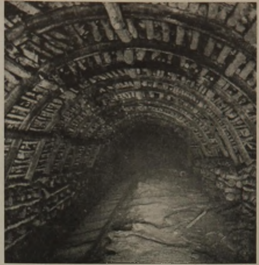
Abb. 10. Zeche Recklinghausen, Flöz Q 1, 4. Sohle, Ort 3 Westen. Toussaint-Heintzmann-Abbaubogen Nr. 4, 2 Jahre nach dem Einbau.
