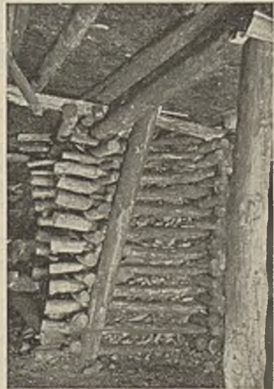
Abb. 21. Mit Fremdbergen angefüllter Standholzpfeiler aus Eichenrundholzstempeln in Flöz Dickebank auf der Zeche Hannibal.
