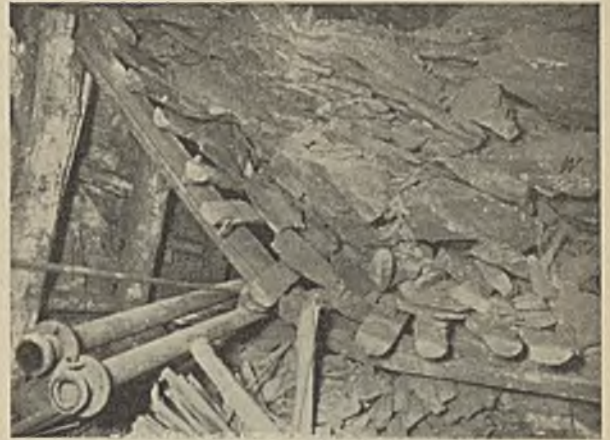
Abb. 7. Verbruch in der Seilförderstrecke.
