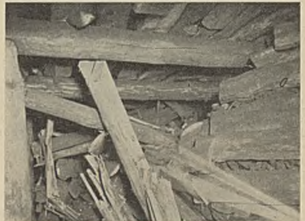
Abb. 8. Verbruch in der Fahrstrecke.
