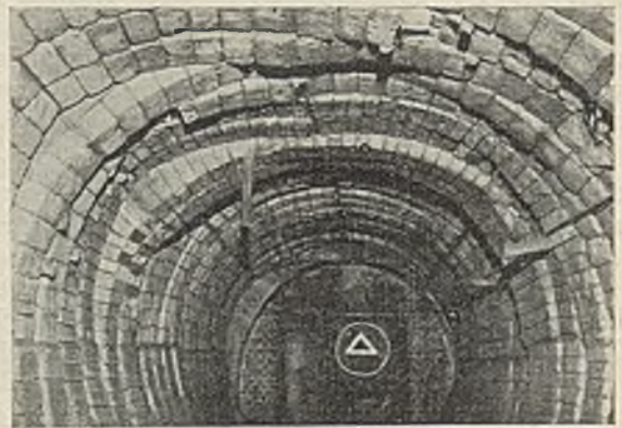
Abb. 2. Infolge einseitigen Druckes zerstörter Betonsteinausbau.
