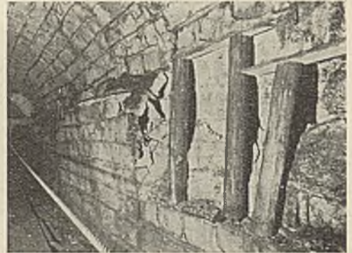
Abb. 3. Zerstörung des Abbaus mit Kastensteinen durch Kantenpressung. Im Hintergrund der Herzbruch-Ausbau.
