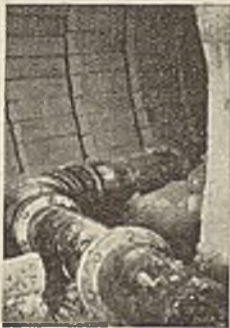
Abb. 1. Rohrkrümmer mit Betonfütter.
