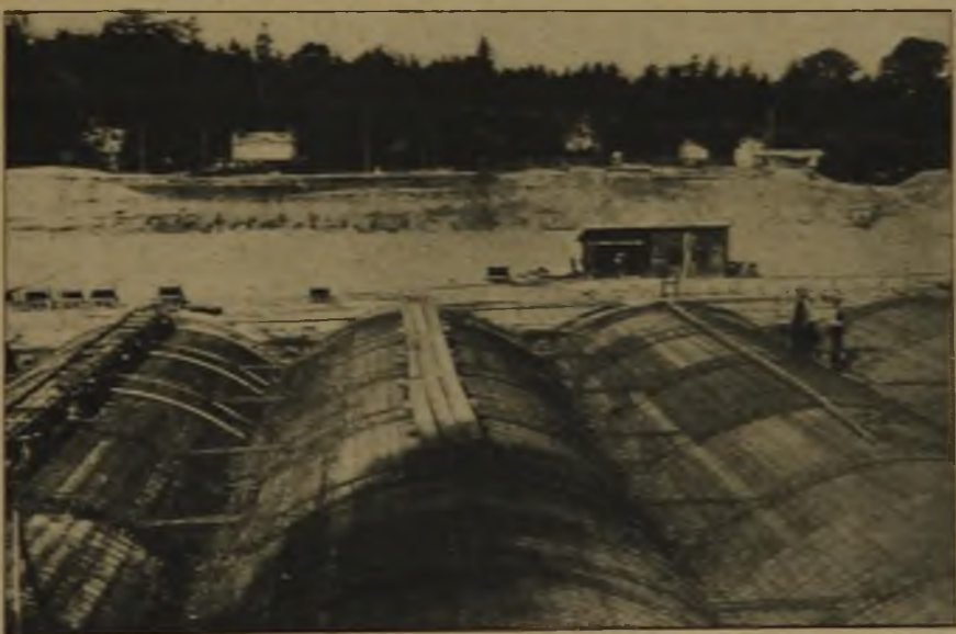
Abbildung 14 u. 15. Einbau der Eiseneinlagen der Gewölbe und Betonierung derselben. Der Hochbehälter III der Wasserversorgung Nürnbergs.
